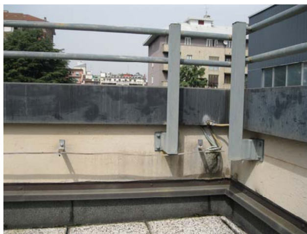
Foto 14: Edificio A – Particolare Gabbia di Faraday
