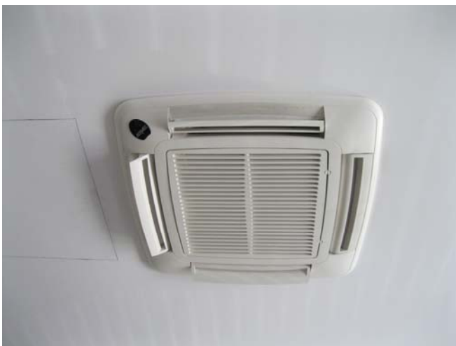
Foto 15: Edificio A – Fancoil a plafone
