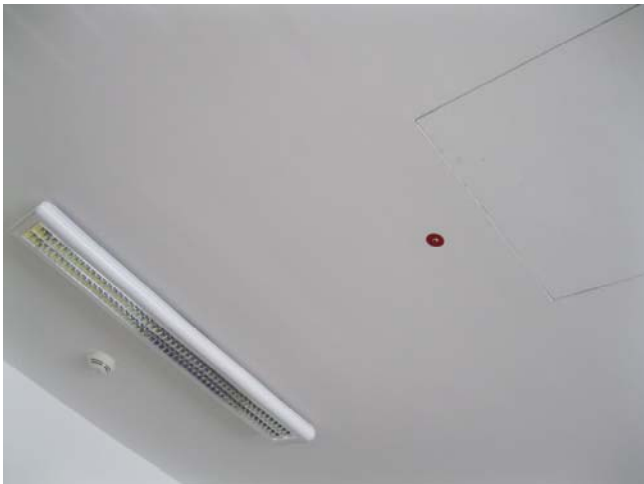
Foto 22: Edificio A – Rilevatori a plafone
