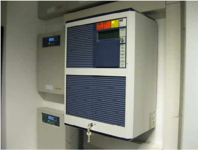
Foto 20: Edificio A – Centralina di rilevazione e allarme
