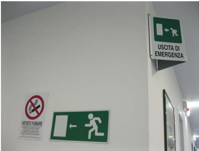
Foto 26: Edificio A – Divieto di fumo, Segnaletica
