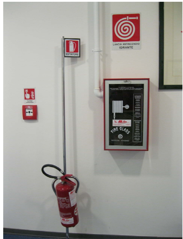
Foto 25: Edificio A – Pulsante allarme, idrante, estintore
