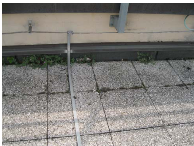
Foto 13: Edificio A – Particolare Gabbia di Faraday
