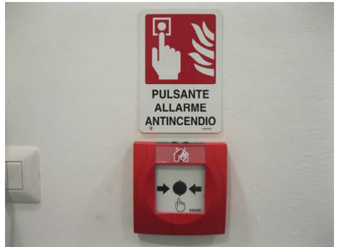
Foto 21: Edificio A – Pulsante allarme incendio
