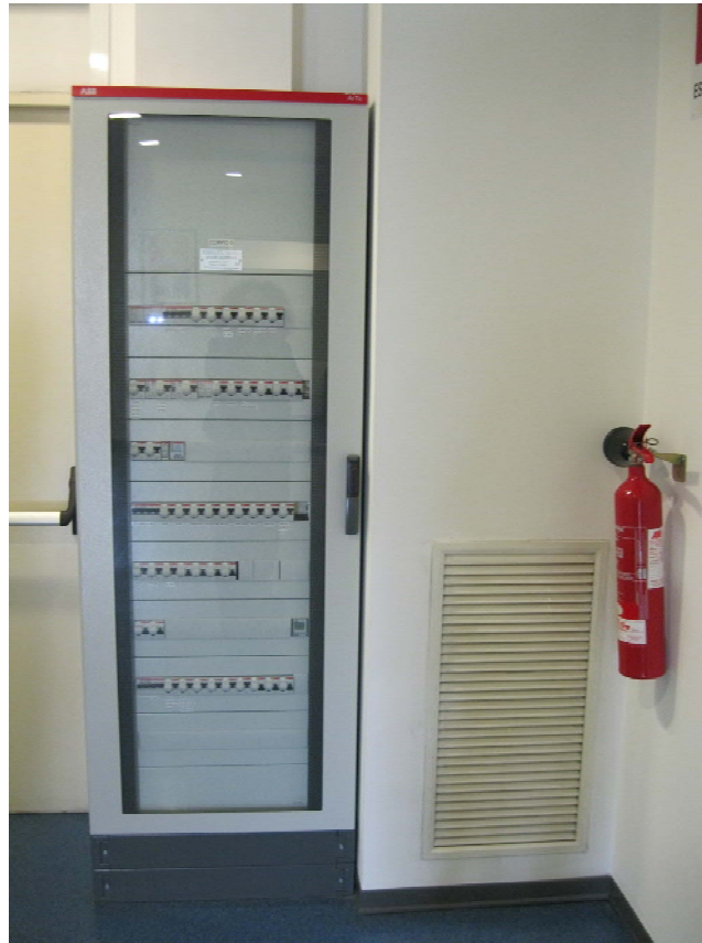
Foto 11: Edificio A – Quadro Elettrico tipo
