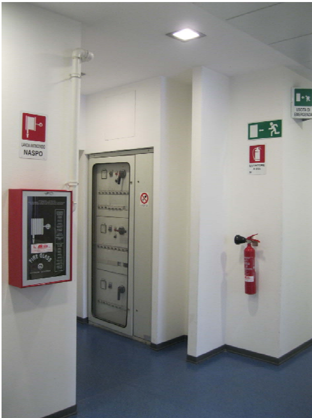
Foto 24: Edificio A – QE, idrante e Estintore a CO2
