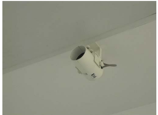
Foto 23: Edificio A – Rilevatore ad infrarosso
