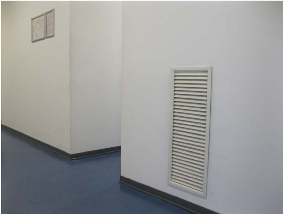
Foto 19: Edificio A – Bocchette i ripresa dell'aria nei corridoi
