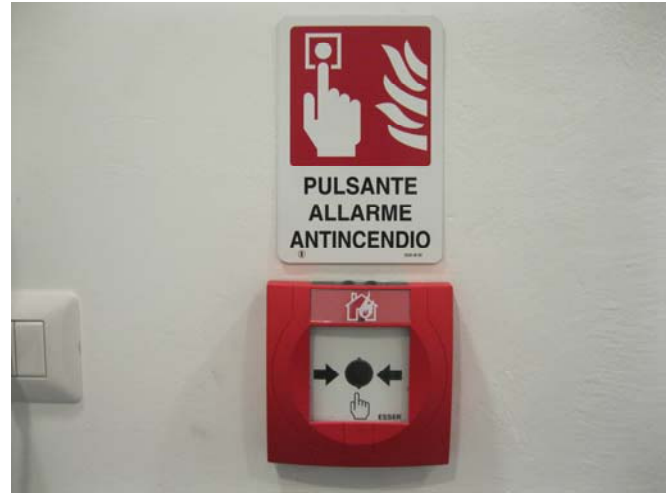
Foto 21: Edificio A – Pulsante allarme incendio
