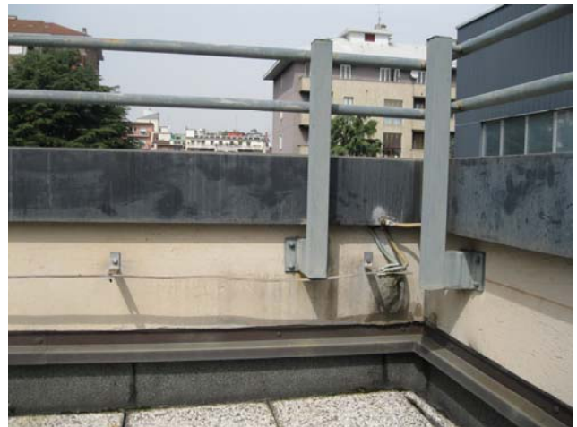
Foto 14: Edificio A – Particolare Gabbia di Faraday
