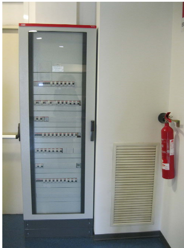
Foto 11: Edificio A – Quadro Elettrico tipo
