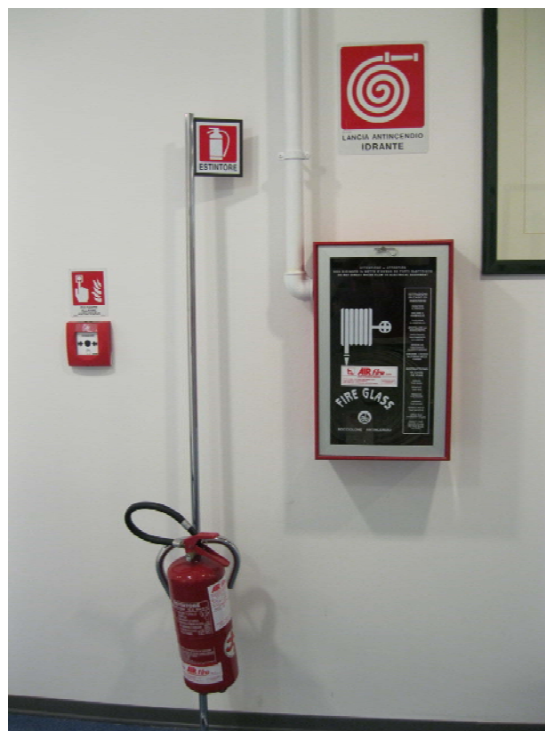
Foto 25: Edificio A – Pulsante allarme, idrante, estintore
