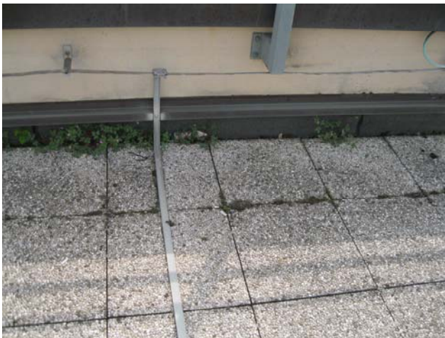
Foto 13: Edificio A – Particolare Gabbia di Faraday
