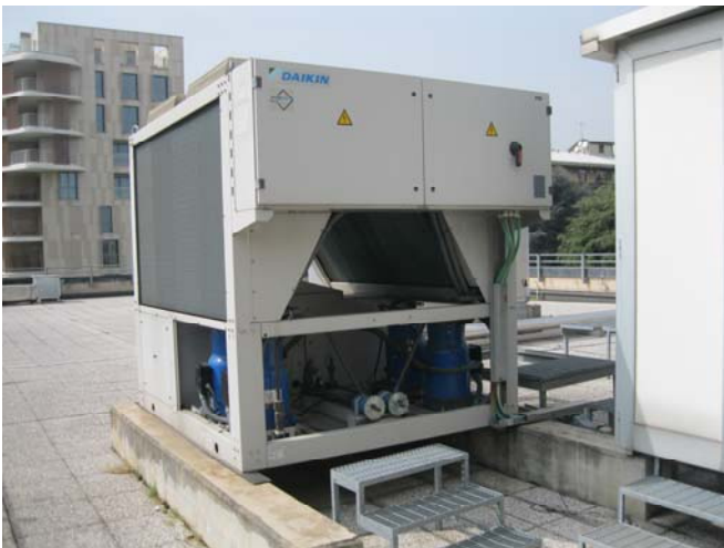
Foto 17: Edificio A – Macchina frigorifera (Chiller)
