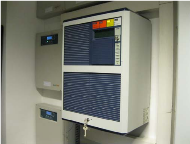
Foto 20: Edificio A – Centralina di rilevazione e allarme
