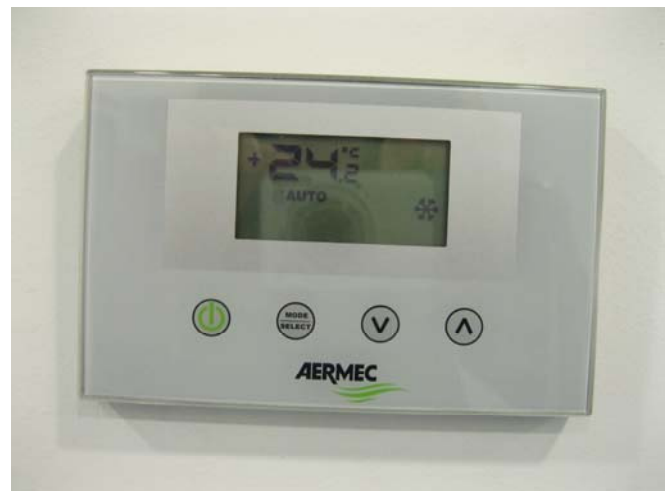
Foto 16: Edificio A – Termostato ambiente
