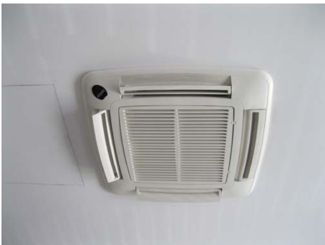
Foto 15: Edificio A – Fancoil a plafone
