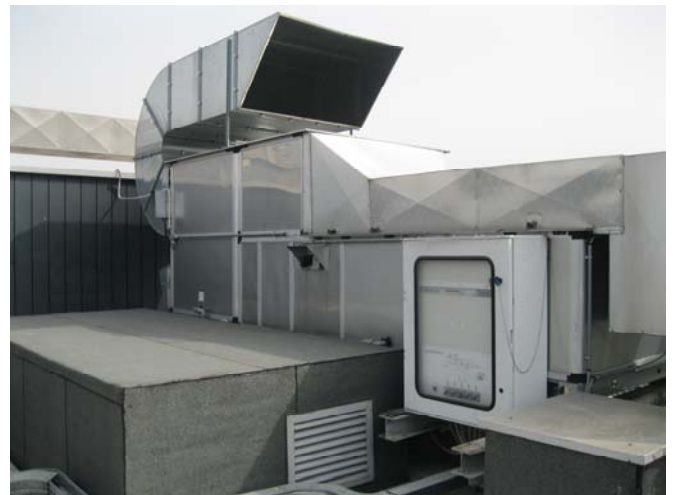
Foto 18: Edificio A – UTA Unità Trattamento Aria
